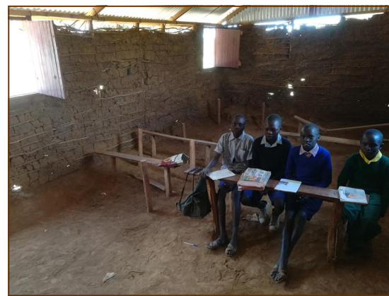
Hali mbaya ya madarasa katika Shule ya Nagum: Juu: Darasa la Nursery; Chini: Darasa la tano.
